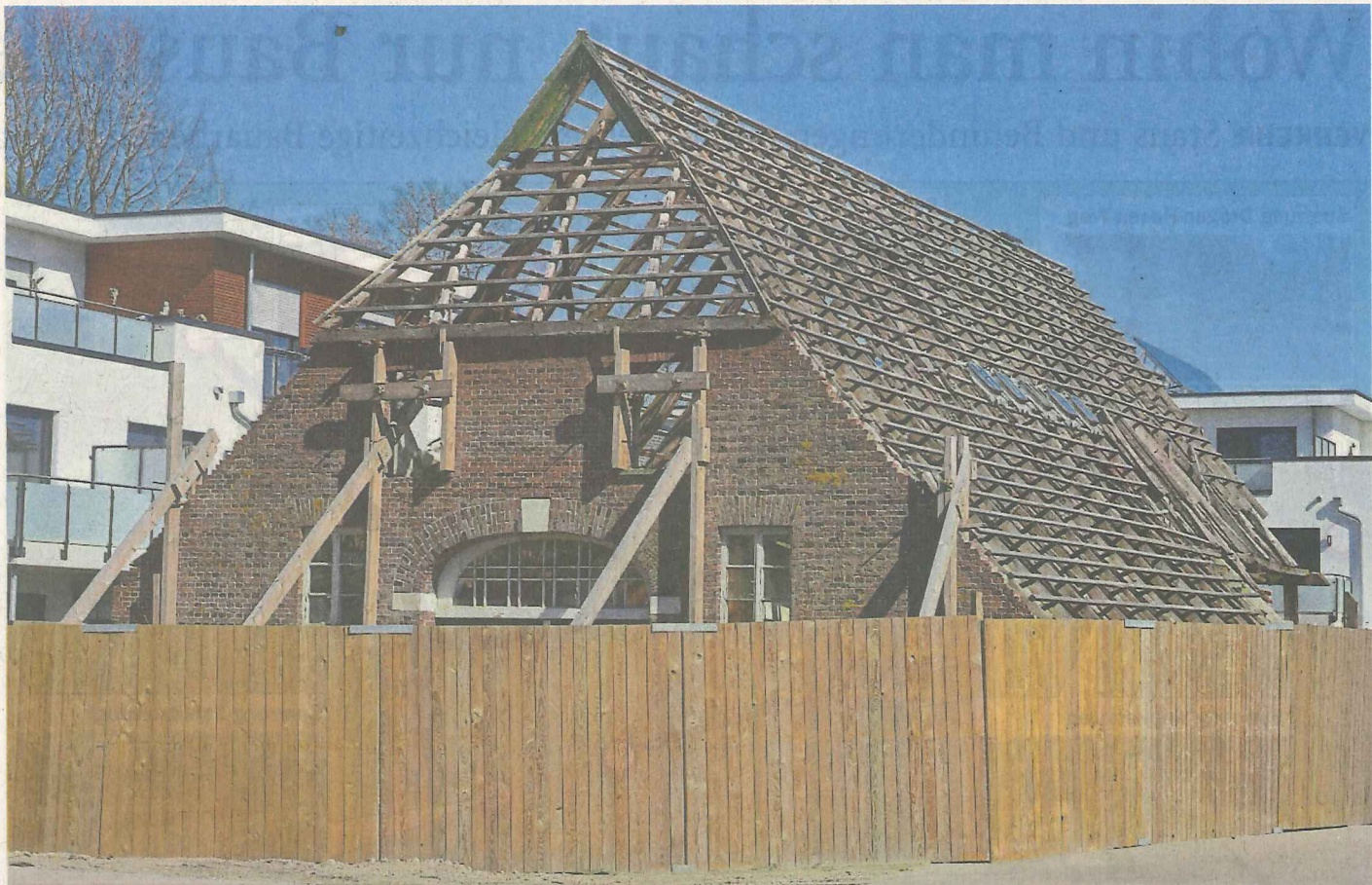
Der Kröger-Hof in Metjendorf: Er soll nach wie vor zur Tagespflegeeinrichtung umgebaut werden. Sobald die Baugenehmigung vorliegt, soll es losgehen, sagt der Bauunternehmer.
